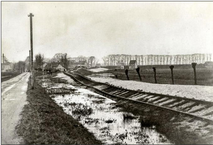
De weggezakte rails bij Stolwijkersluis
